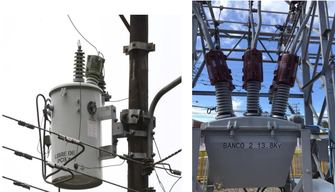
Figura 29 B. Izquierda: protectores de polímero rígido para protección de terminal en transformador (Fuente: ESPH); y a la derecha protector rígido colocados en aisladores de porcelana de interruptores de subestación (Fuente: CNFL).
