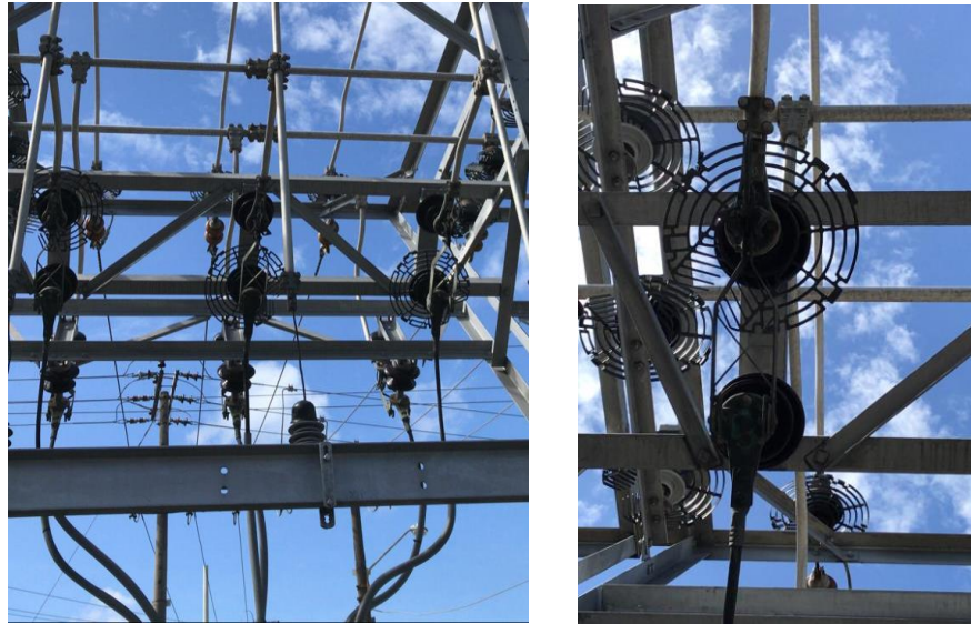
Figura 25. Dispositivos electroestáticos colocados sobre los aisladores de porcelana de los soportes de las cuchillas en una subestación, diseño y forma correcta de colocar (imágenes fuente CNFL)
