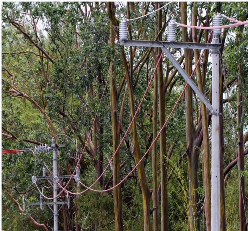
Figura 30. C. Protectores de polímero rígido para el cable (Fuente: ESPH).
