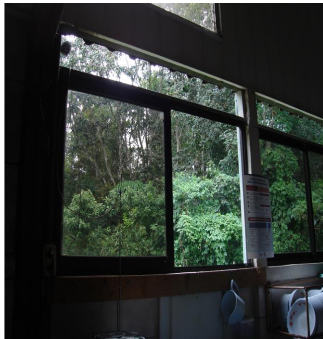
Fotografía 54. Ventanas sin protección y espacios abiertos entre pared y techo
