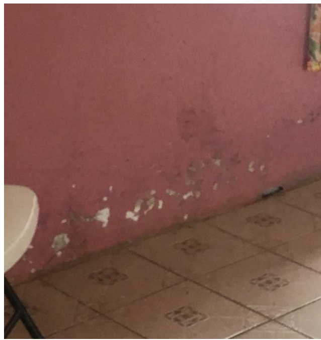
Fotografía 45. Pared con deterioro por humedad
