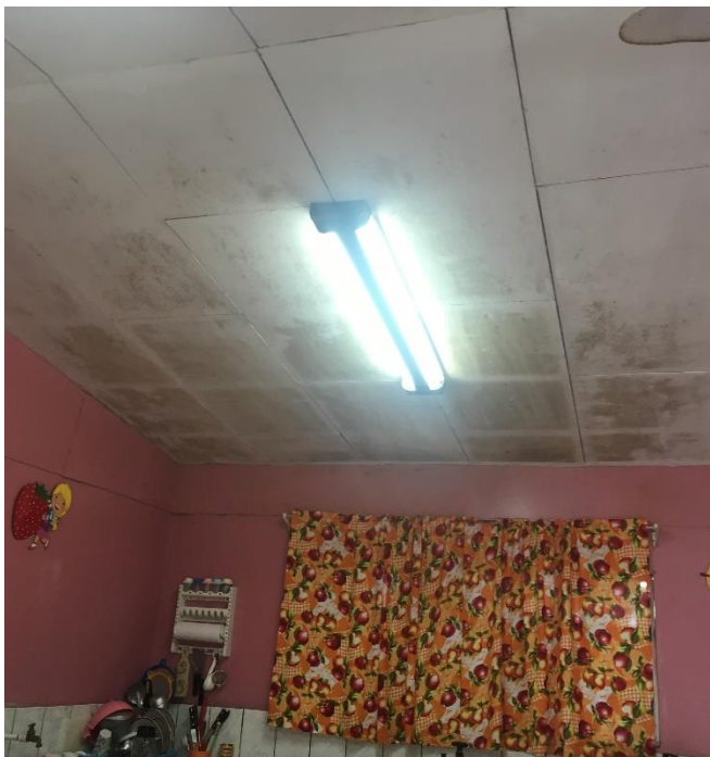
Fotografía 42. Cielo raso deteriorado
