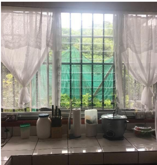
Fotografía 46. Ventanas carentes de protección
