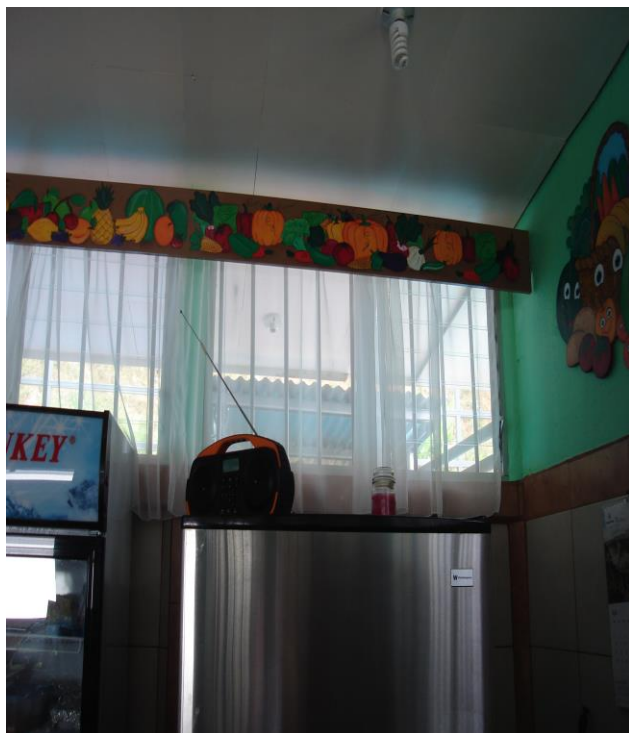
Fotografía 23. Ventanas carentes de protección
