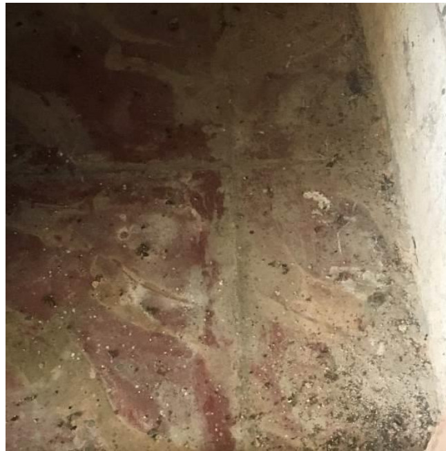
Fotografía 41. Piso con acumulación de suciedad
