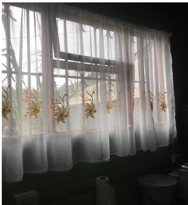
Fotografía 13. Ventanas de la cocina sin protección
