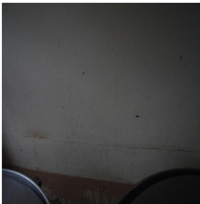
Fotografía 55. Pared con acumulación de suciedad
