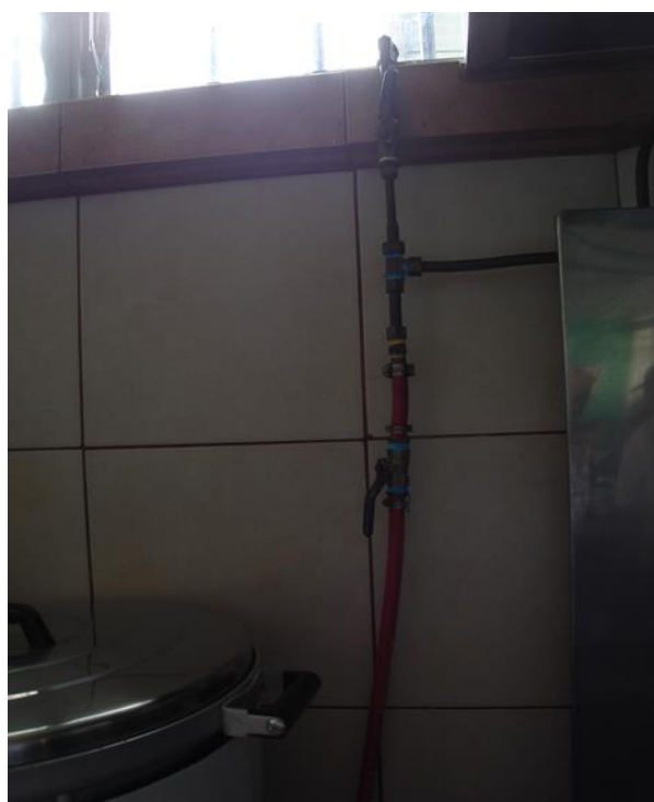
Fotografía 24. Tubería de gas LP no certificada
