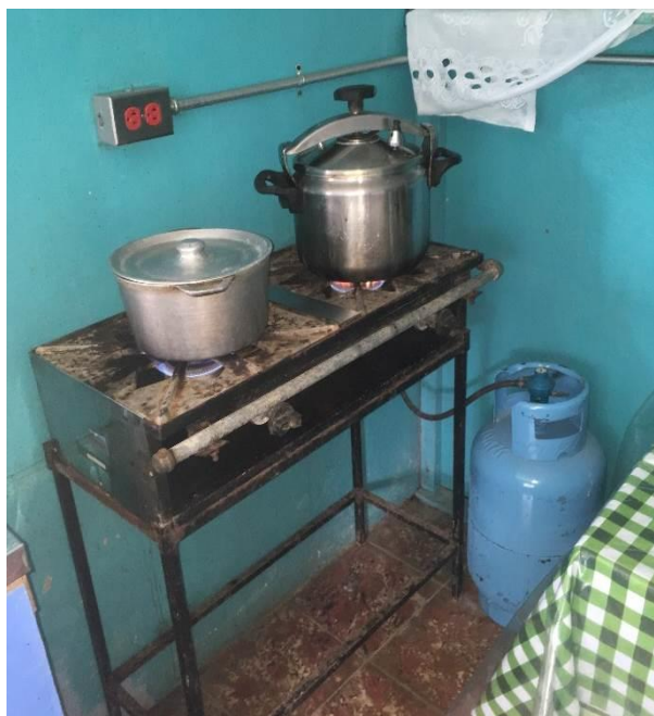
Fotografía 17. Equipo con oxidación
