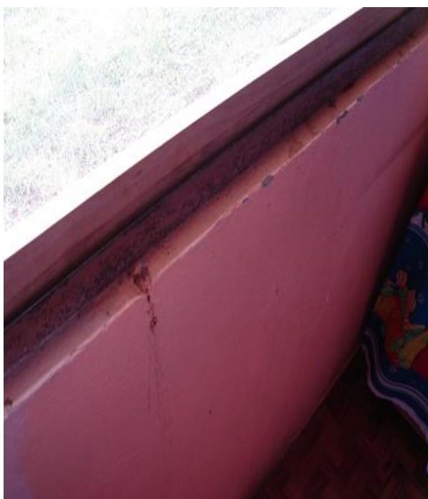
Fotografía 27. Marco de la ventana con oxidación.
