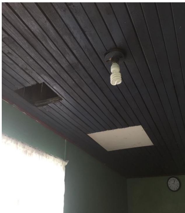
Fotografía 11. Cielo raso permeable y de color oscuro
