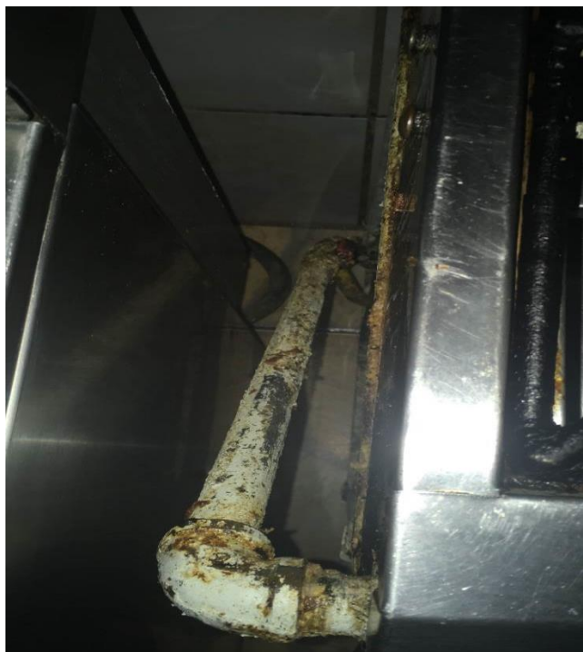
Fotografía 57. Tubería de gas LP, con acumulación de grasa
