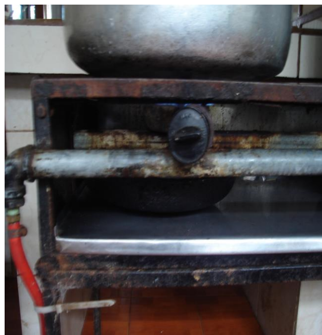
Fotografía 56. Equipo con oxidación
