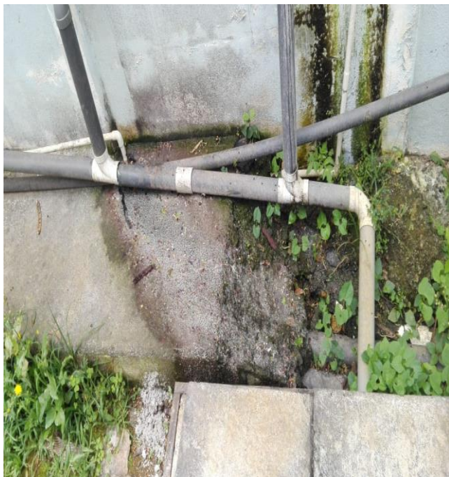
Fotografía 53. Tubería de salida de agua servida con fuga
