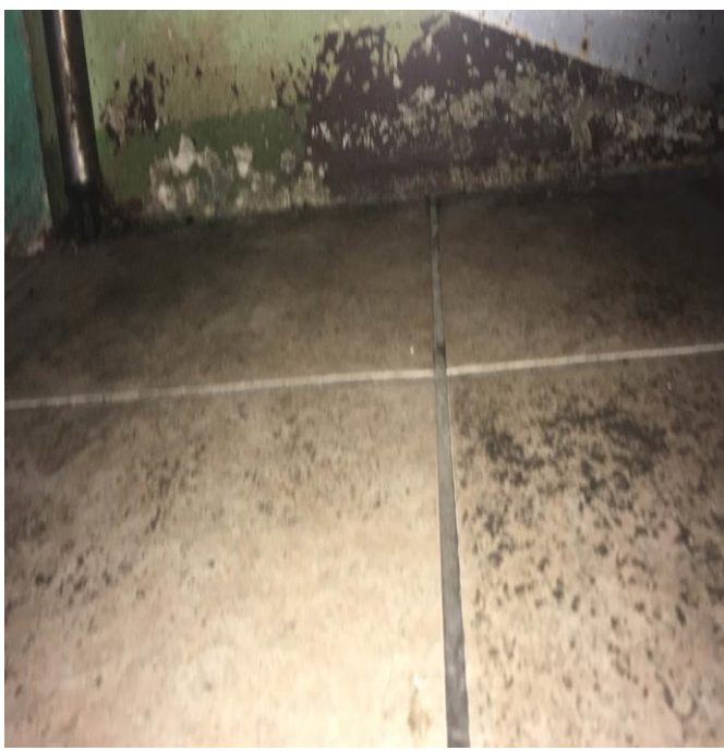
Fotografía 60. Pared con deterioro de pintura
