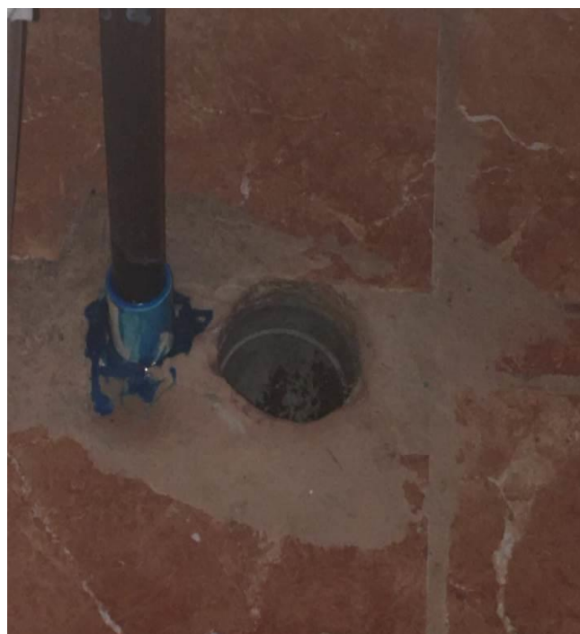
Fotografía 50. Desagüe del piso sin protección
