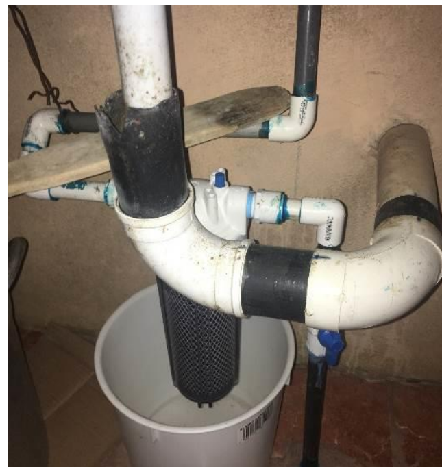
Fotografía 52. Tubería sin protección
