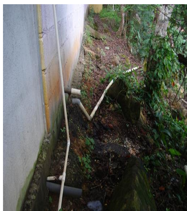
Fotografía 28. Descarga a la libre del agua servida
