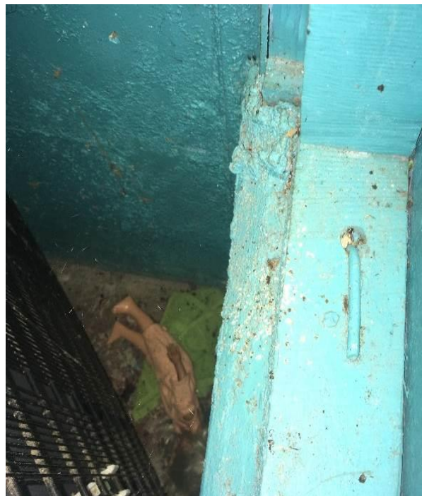
Fotografía 16. Piso con acumulación de suciedad
