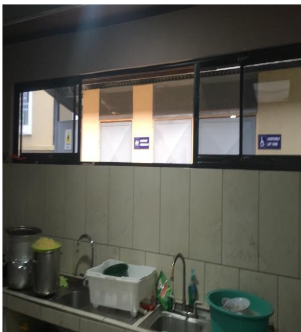
Fotografía 31. Ventanas carentes de protección
