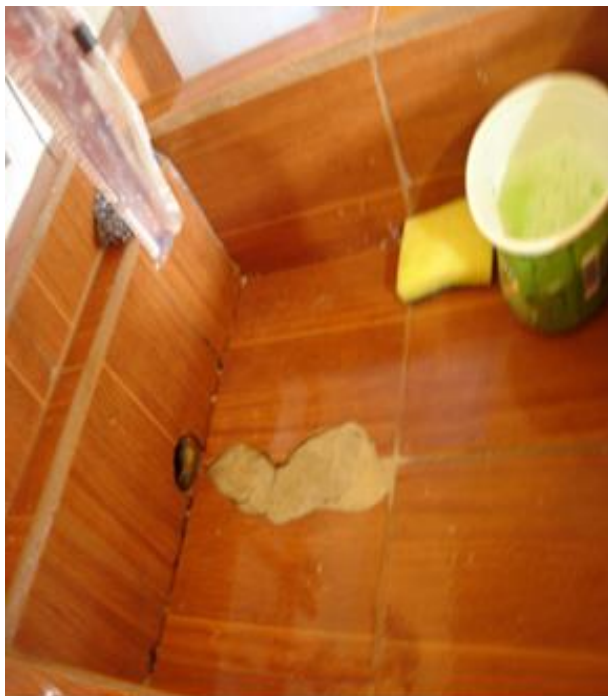
Fotografía 25. Fregadero con grietas
