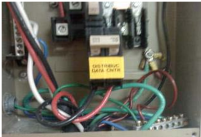
Figura 25: Tablero y cableado eléctrico en el Centro de Datos actual, El Alto
