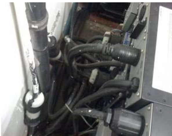
Figura 26: Conexión de la UPS en el Centro de Datos actual, El Alto
