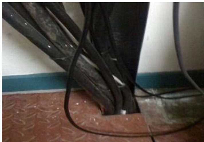
Figura 24: Cableado eléctrico en el Centro de Datos actual, El Alto
