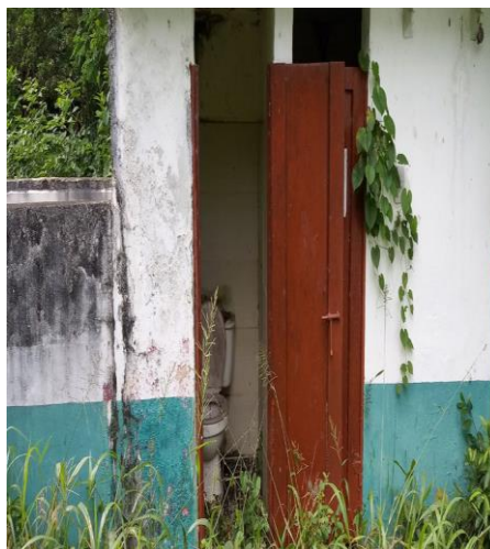
Figura 10. Instalación Sanitaria Inadecuada
