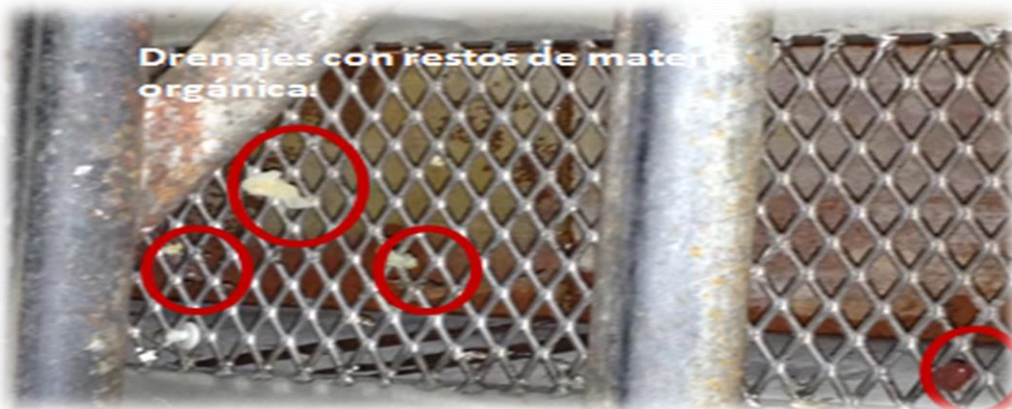
Figura 11. Drenaje sucio con restos de materia orgánica.
