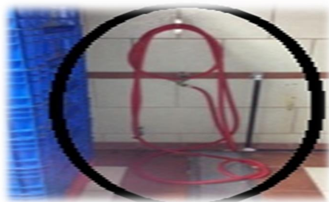
Figura 12. Manguera en contacto con el piso sin arrollar.
