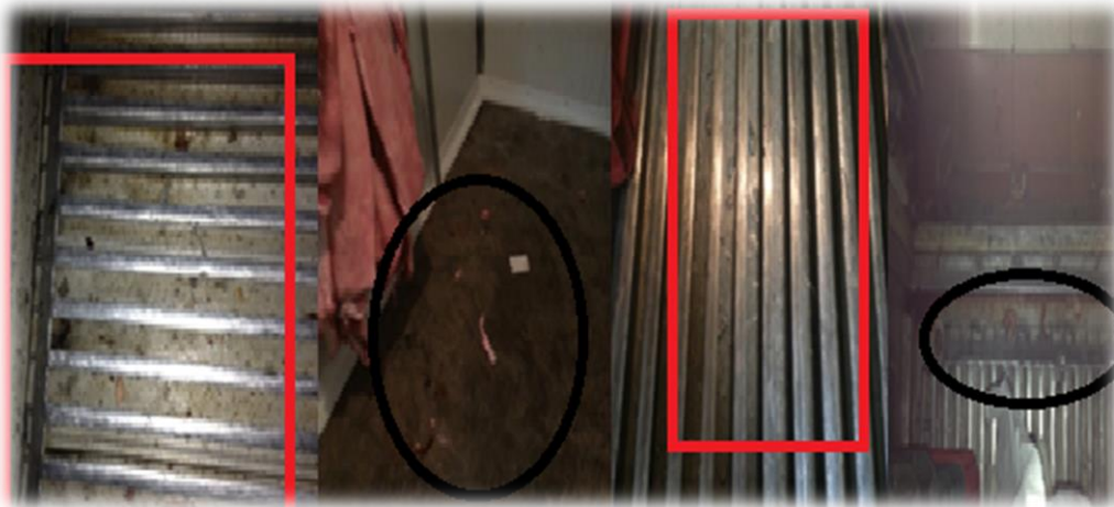
Figura 10. Pisos de las cámaras sucios, con restos de carne o sangre.
