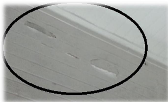
Figura 6. Techo del área de proceso con pintura descascarada.
