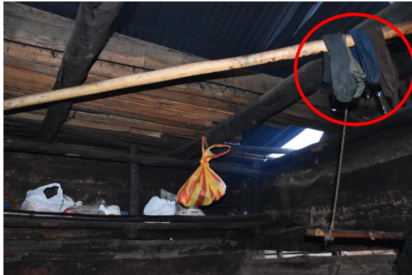
Figura 14: Fotografía de los estantes desordenados y en mal estado en la cabaña de la Laguna de los Cóndores
