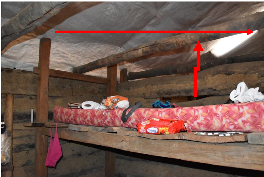
Figura 6: Fotografía de una cama camarote en la cabaña de la Laguna de los Cóndores
