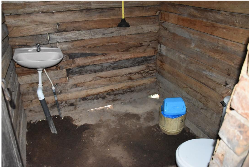
Figura 9: Fotografía de los servicios higiénicos en la cabaña de la Laguna de los Cóndores
