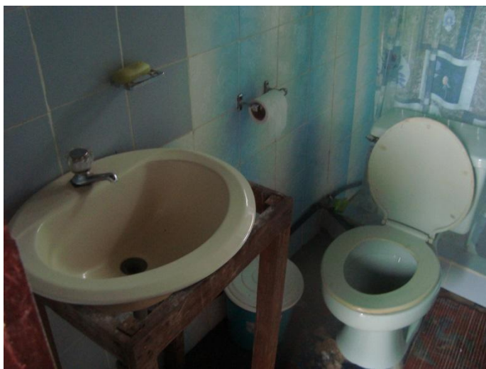
Instalaciones sanitarias en la Reserva Los Tigrillos en Playa Rica
