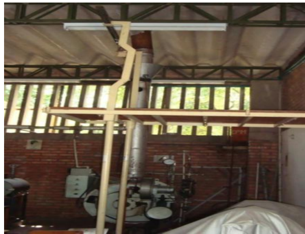
Figura 15. Caldera ubicada Laboratorio. Transferencia, UFPS Fuente: Elaboración propia
