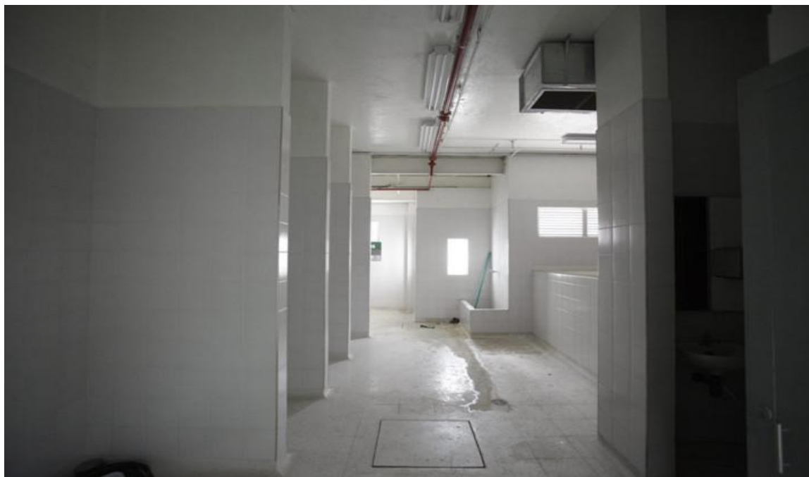
Fotografía 4, Plataforma Los Luceros, cuarto de residuos. Fuente el Autor
