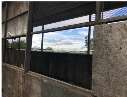
Figura 23. Ventanales en mal estado
