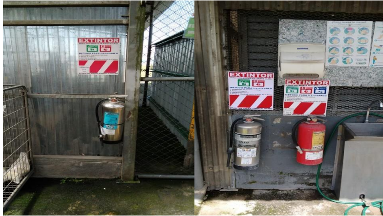
Figura 11. Extintores ubicados en Centro de Acopio Coyol. Fuente propia
