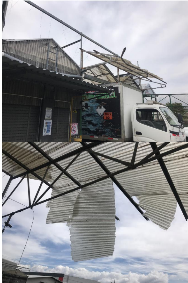
Figura 30. Techo en malas condiciones.
