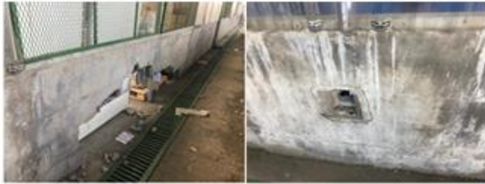
Figura 24. Paredes en mal estado
