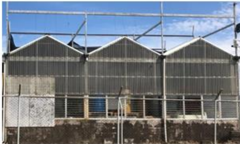
Figura 29. Fachada en malas condiciones de la bodega de residuos peligrosos.
