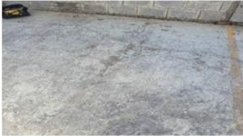
Figura 28. Fisuras y pintura epóxica deteriorada en área de almacenamiento de residuos peligrosos.
