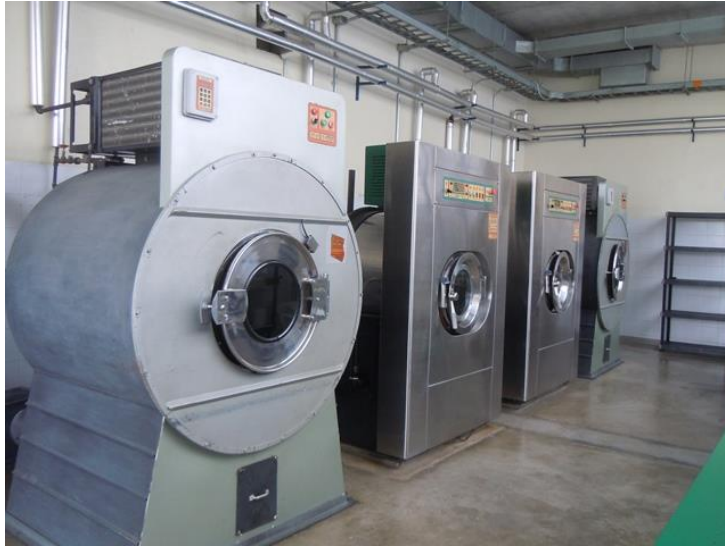
Figura 13. Cuarto de lavandería en complejo penitenciario de Jamundí
