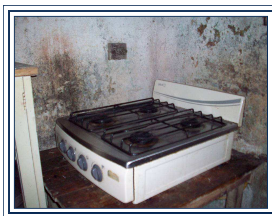
Figura 28 Cocina en mal estado.
