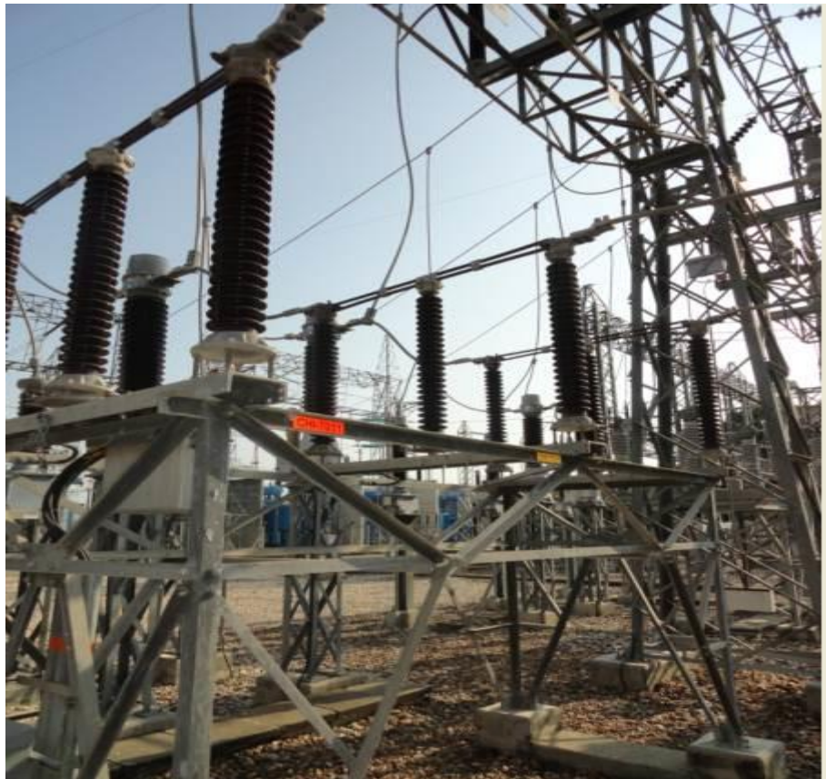
Figura 6 Seccionador 110kV. (Fuente: imagen del autor)
