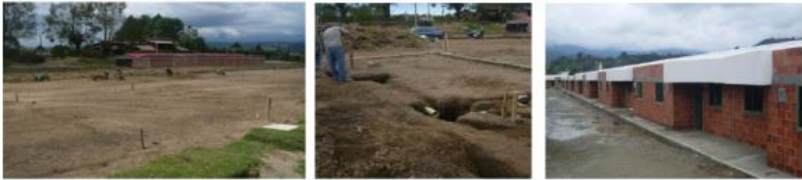
Figura 2. Vivienda de Interés Social VIS_Urbanización Palmares de la Villa. Fuente (Informe de interventoría CT INGENIERIA S.A.S,2013).
