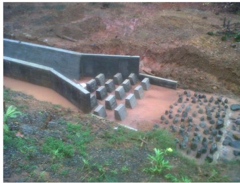
Figura 3. Canalización quebrada San José municipio de Sevilla. Fuente (Informe de obra canalización CT-INGENIERIA S.A.S, 2013).
